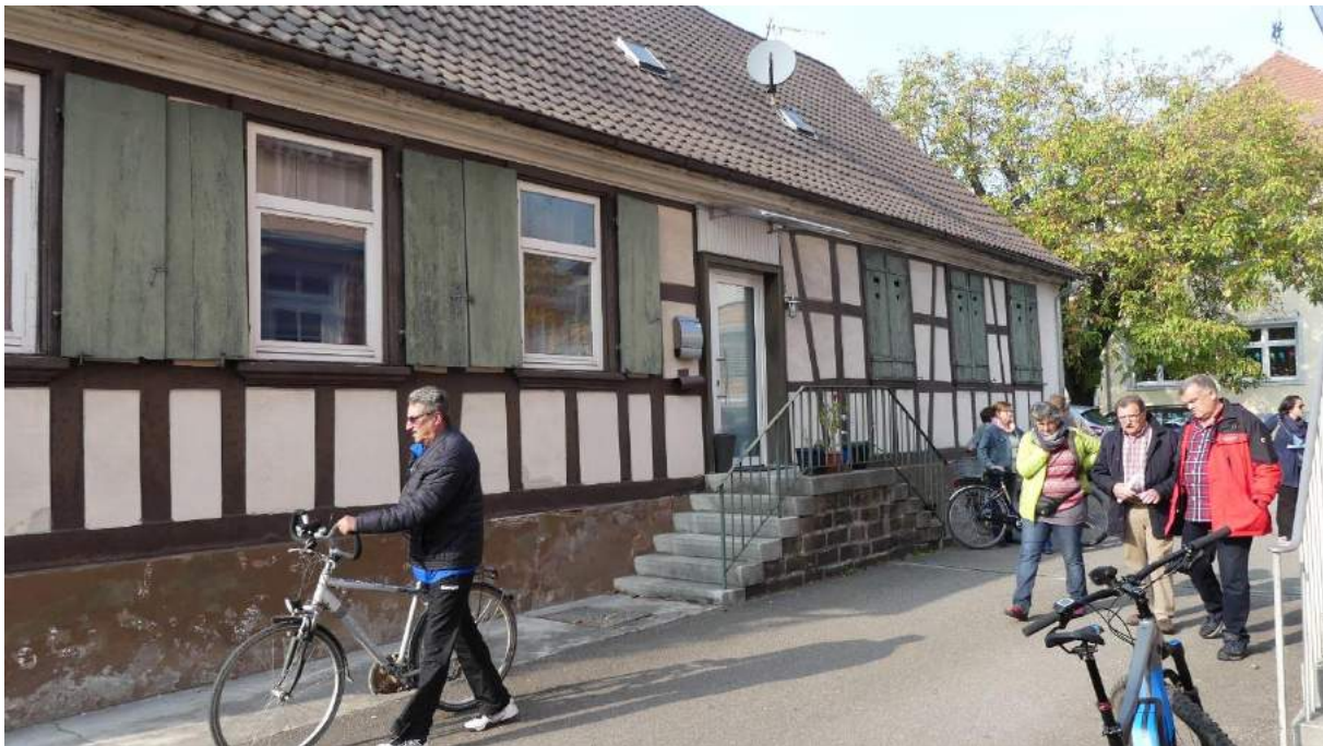
Abbildung: sanierungsbedürftiges, ehem. Lehrerhaus
